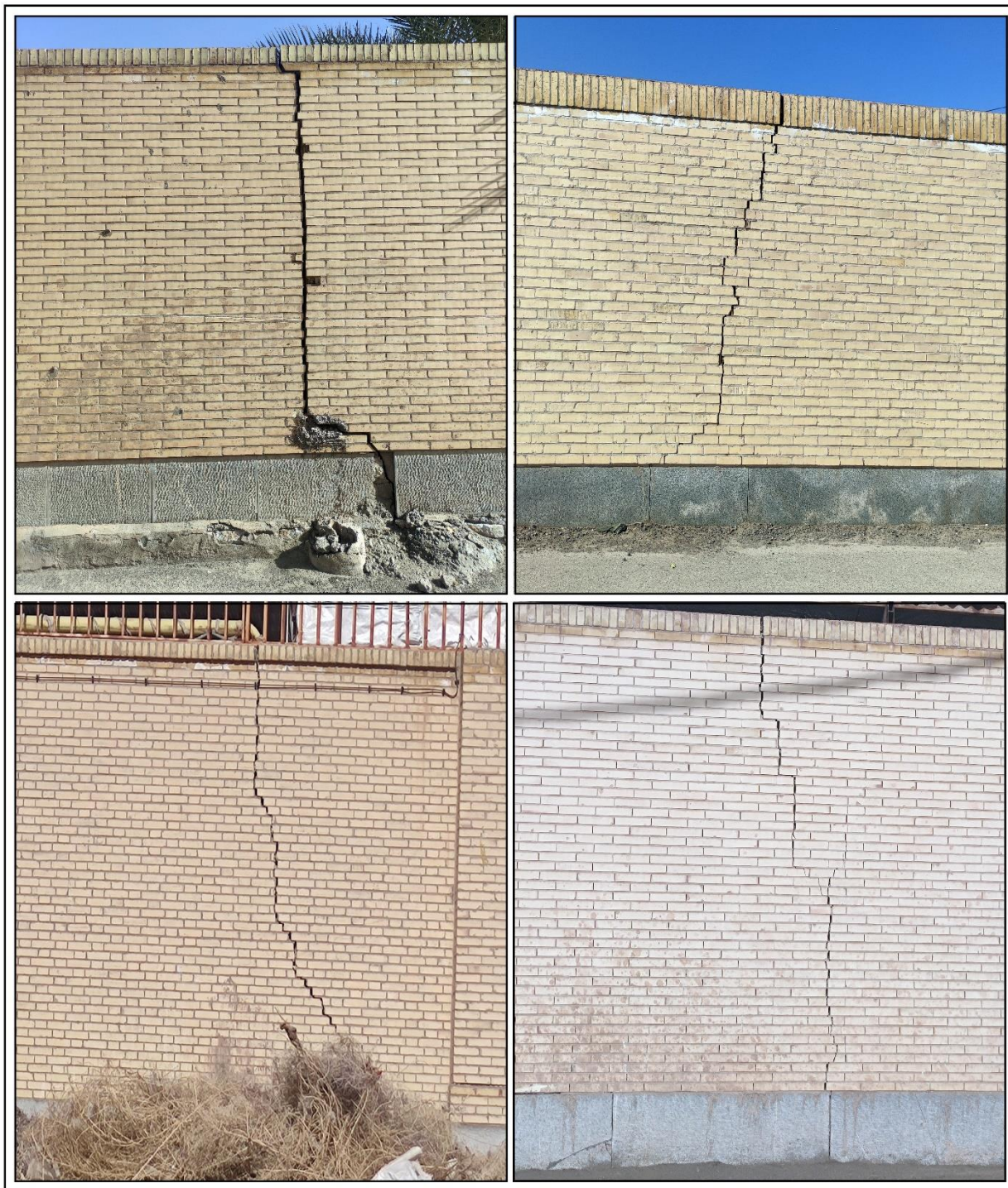
شکل ۴- ترک ها و جدایش های عمودی در دیوار سازه ها ناشی از فرونشست منطقه ای
