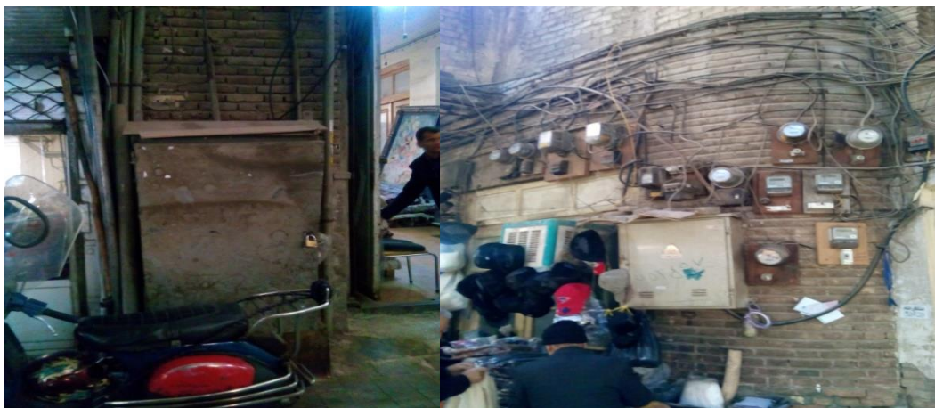
شکل ۵- نمایی از نابسامانی شبکه کابل‌ها و پست‌های برق نایمن در بازار
